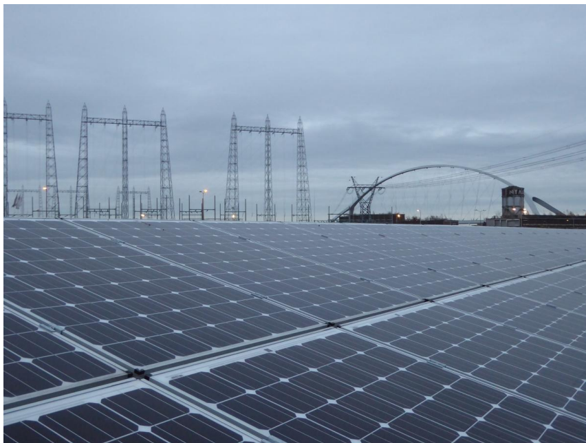
Figuur 15 Zonnepark Engie locatie G13 te Nijmegen, 1,04 MWpiek, met 4.000 panelen Gerealiseerd in 2015, start 6 november. Opbrengst circa 1 GWhe per jaar.
